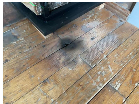
Svimerke på gulv i stue.
