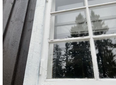
Enkelte vinduer bærer preg av slitasje.
