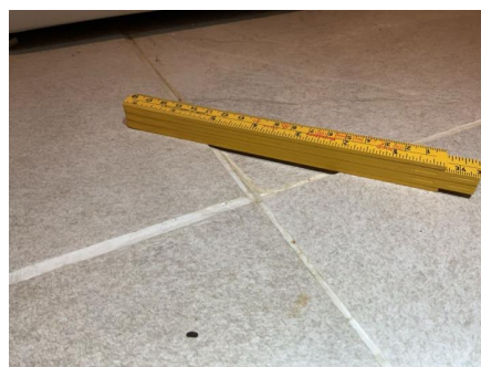
Høydeforskjell på fliser.
