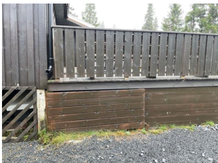
Det er registrert skjevheter i konstruksjonen.
