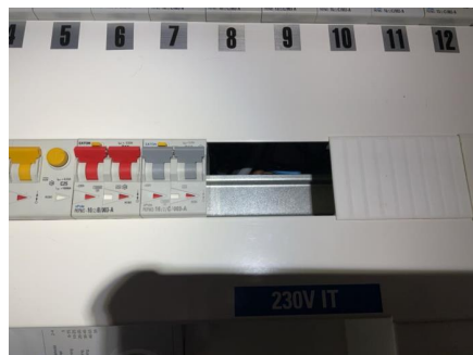
Manglende tildekking i sikringskap.
