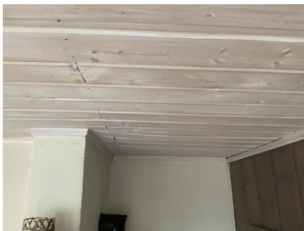
Nedbøyning på himling flere steder.
