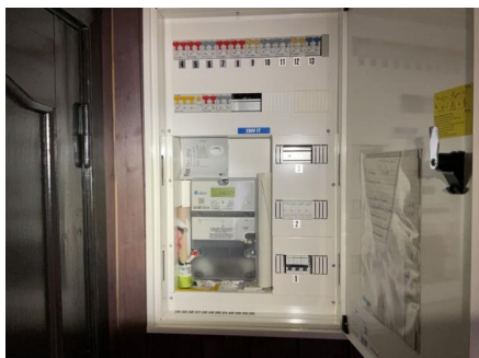
Sikringskap plassert på kjøkken.
