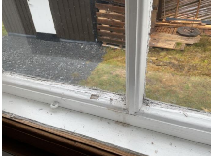
Kondensmerker/fuktmerker på enkelte vinduer.
