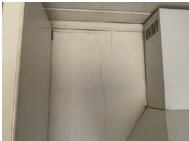
Sprekker i pipe/brannvegg mot kjøkken.
