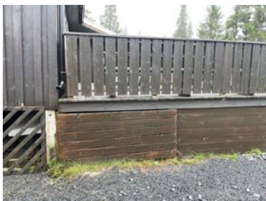
Det er registrert skjevheter i konstruksjonen.
