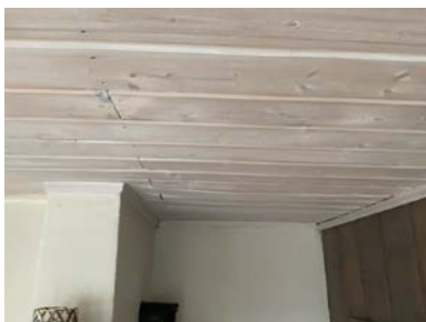
Nedbøyning på himling flere steder.
