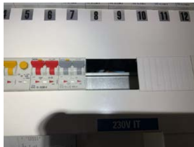
Manglende tildekning i sikringsskap.
