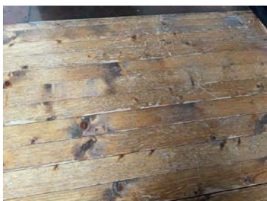
Slitasje på overflater.
