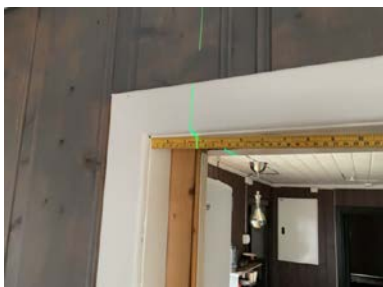
Omramning rundt dør er 7cm ute av vater. Dette må ses i sammenheng med skjevheter i yttervegger.
