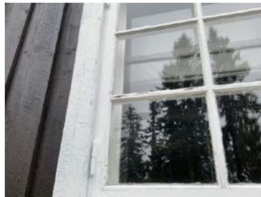
Enkelte vinduer bærer preg av slitasje.
