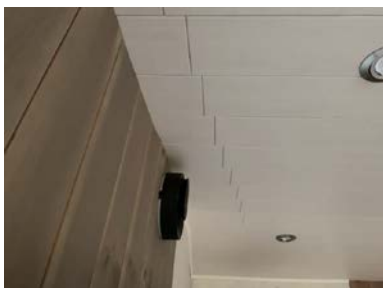
Ufagmessig utførelse på himling.
