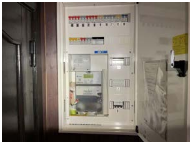
Sikringsskap plassert på kjøkkenet.
