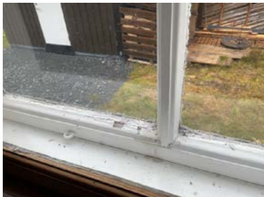
Kondensmerker/fuktmerker på enkelte vinduer.
