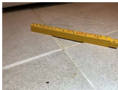
Høydeforskjell på fliser.
