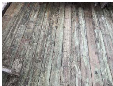
Behov for vedlikehold på overflater.
