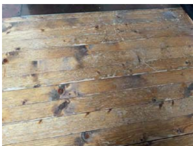
Slitasje på overflater.
