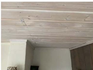
Nedbøyning på himling flere steder.
