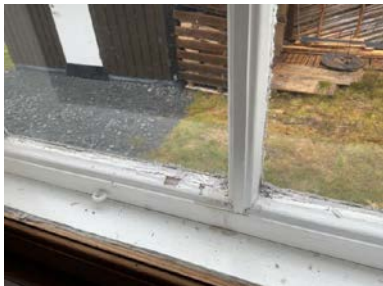
Kondensmerker/fuktmerker på enkelte vinduer.
