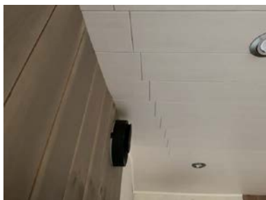
Ufagmessig utførelse på himling.
