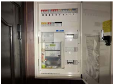
Sikringsskap plassert på kjøkken.
