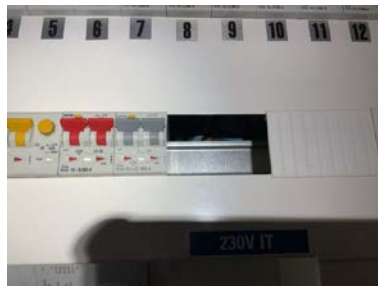
Manglende tildekking i sikringsskap.
