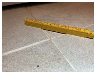
Høydeforskjell på fliser.
