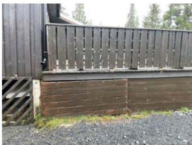
Det er registrert skjevheter i konstruksjonen.
