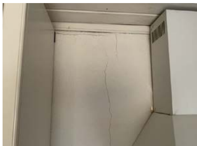
Sprekker i pipe/brannvegg mot kjøkken.
