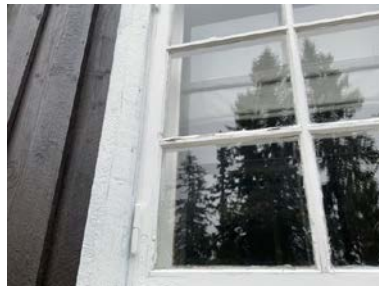
Enkelte vinduer bærer preg av slitasje.
