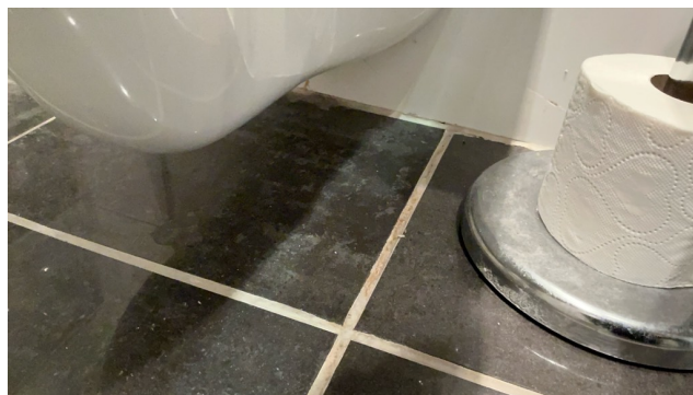
Lekkasjespalte på innebygget systerne bør opparbeides.
