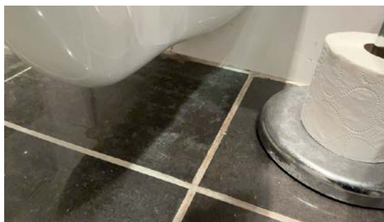
Lekkasjespalte på innebygget sistene bør opparbeides.
