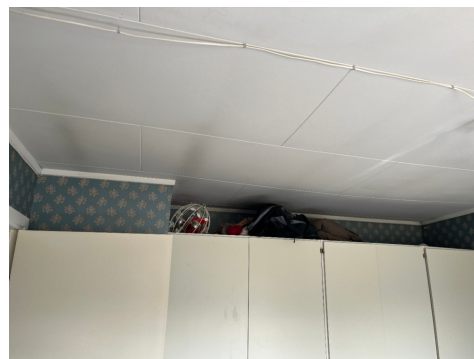
Himlingsplater har støvkondens (mørke felter) og har delvis løsnet.
