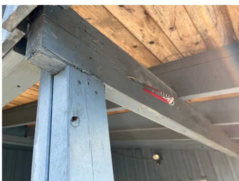
Råte i drager under terrassetak.
