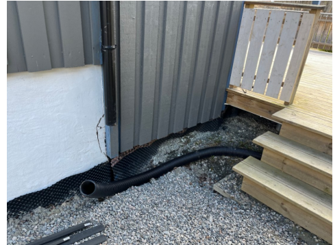
Takvann bør ledes vekk fra bygning.
