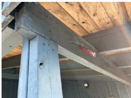
Råte i drager under terrassetak.
