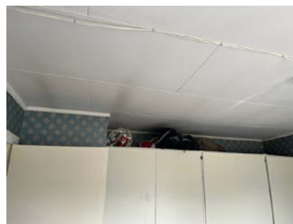
Himlingsplater har støvkondens (mørke felter) og har delvis løsnet.
