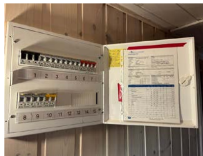
Sikringsskap i kjelleretasje.
