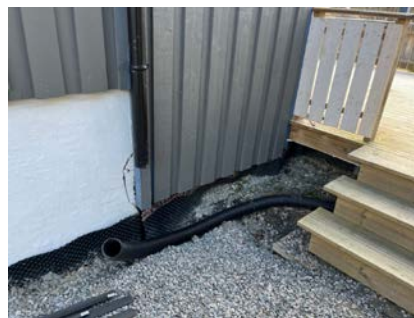
Takvann bør ledes vekk fra bygning.
