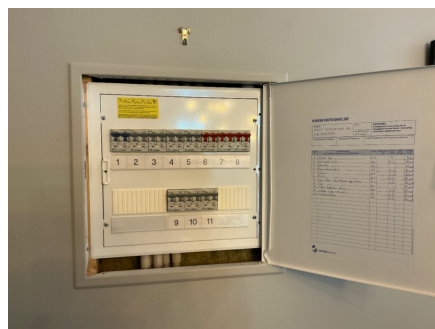
Automatsikringer i sikringsskap plassert i kjøkken.
