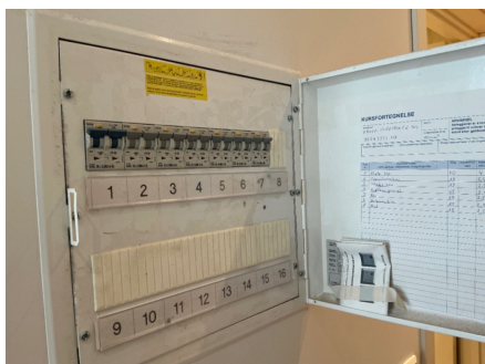
Automatsikringer i sikringsskap plassert i stue/kjøkken.
