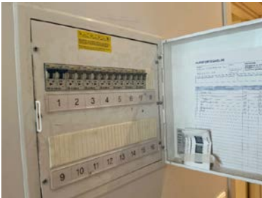
Automatsikringer i sikringsskap plassert i stue/kjøkken.
