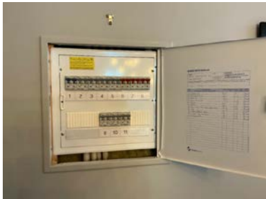
Automatsikringer i sikringsskap plassert i kjøkken.
