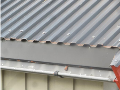
Rustdannelse i platekanten.
