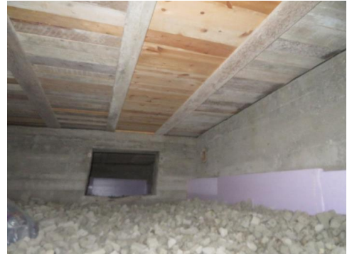
Del av kryptjeller sett fra inspeksjonsluke i murlivet. Glasopor til terreng samt isolasjonsplater til murlivet som frostsikringer.
