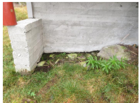
Terrenget ses dels noe utvasket under muren.
