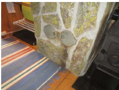
Det mangler ildfast plate til gulv under sotlukene.
