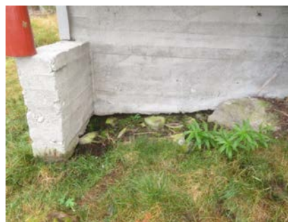
Terrenget ses dels noe utvasket under muren.
