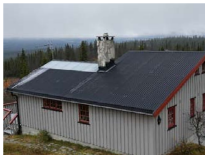
Det er ikke montert stigetrinn/takstige eller feierplattform for feier. Takrenner er over 25, noe som tilsier at mer enn halvparten av forventet levetid er forbi jfr. levetidstabeller.
