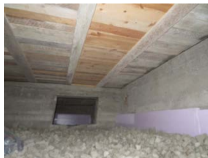
Del av krypkjeller sett fra inspeksjonsluke i murlivet. Glasopor til terreng samt isolasjonsplater til murlivet som frostsikringer.
