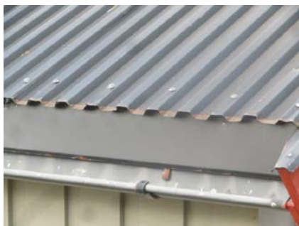
Rustdannelse i platekanten.
