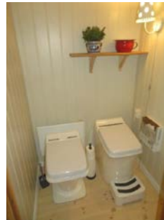
Toalettrom med pissoardo samt forbrenningstoalett.
