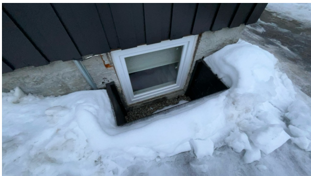
Rekkverk eller metallrist bør opparbeides for sikring av fallhøyder.
