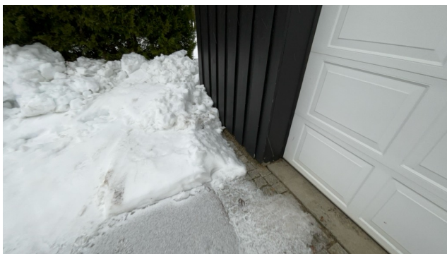
Bordkledning ligger for lavt ned til terreng.
