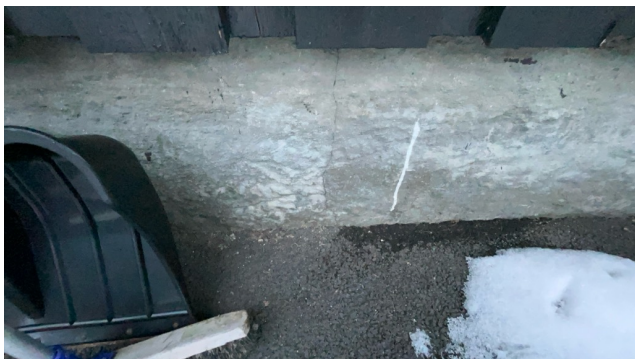
Stedvis behov for lokale utbedringer.
