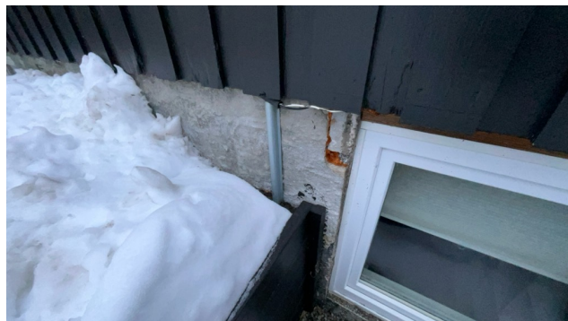
Stedvis behov for lokale utbedringer.
