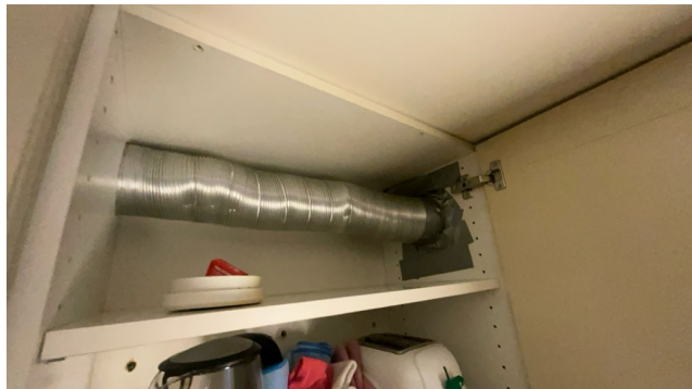
Utbedringer av røroverganger bør utføres.
