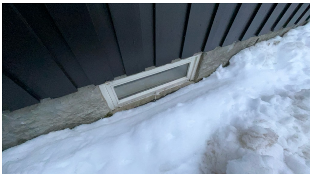
Vindu ligger lavt ned mot terreng. Lysgrav bør opparbeides.
