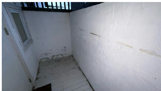
Stedvis behov for lokale utbedringer.
