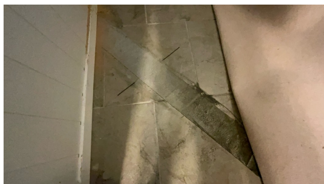
Synlig avvik på flislagt gulv under teppe på sovealkove.
