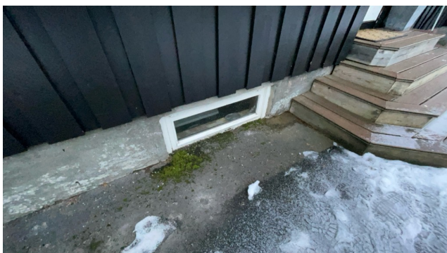
Vindu ligger lavt ned mot terreng. Lysgrav bør opparbeides.
