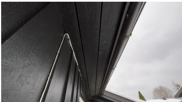
Synlige luftespalter i gesimskasse.
