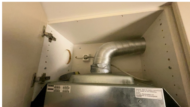
Utbedringer av røroverganger bør utføres.
