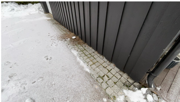
Bordkledning ligger for lavt ned til terreng.
