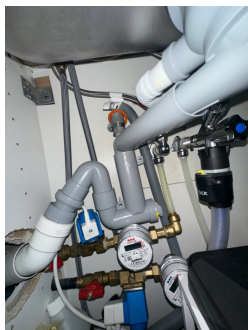
Røropplegg i kjøkkenbenk med Waterguard
