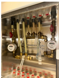
Samleskap med rørkurser og stoppekraner
