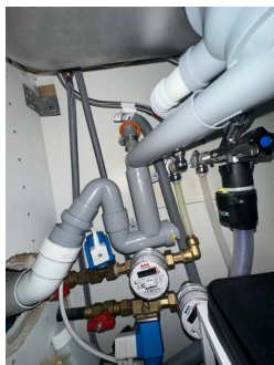
Rørøpplegg i kjøkkenbenk med Waterguard
