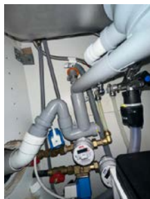
Røropplegg i kjøkkenbenk med Waterguard
