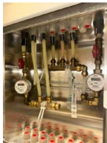
Samleskap med rørkurser og stoppekranner
