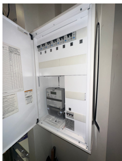
Sikringsskap med automatsikringer.
