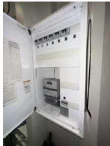
Sikringsskap med automatsikringer.
