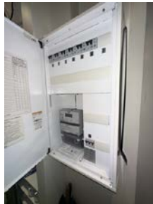
Sikringsskap med automatsikringer.
