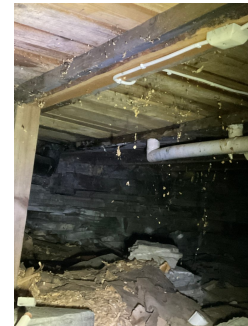
Det kan se ut som om det er fukt i konstruksjon i konstruksjon under bad.
