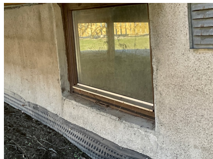
Mangler beslag under kjellervinduene.
