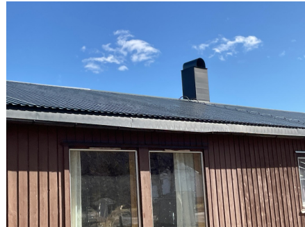
Skader/nedbøyninger i takrenner
