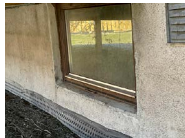
Mangler beslag under kjellervinduene.
