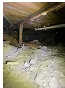
Usikkerhet omkring eventuell fukt i konstruksjon under bad.
