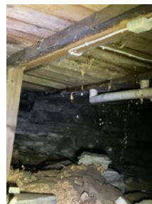
Det kan se ut som om det er fukt i konstruksjon i konstruksjon under bad.
