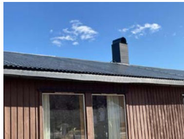
Skader/nedbøyninger i takrenner
