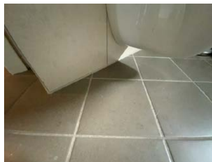
Lekkasjespalte på innebygget sisterner bør opparbeides.
