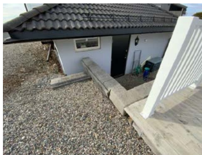
Rekkverk bør opparbeides for sikring av fallhøyder.
