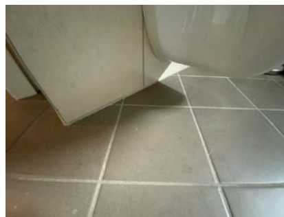
Lekkasjespalte på innebygget sisterne bør opparbeides.
