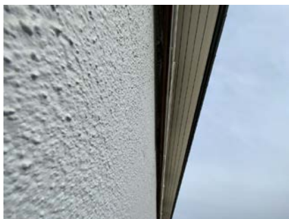
Minimalt med lufting.
