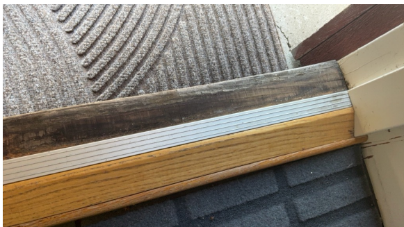
Slitasje på terskel på hovedentre
