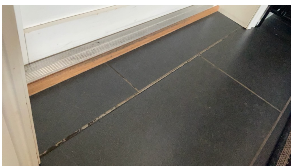
Det sprekker opp i fuger ved dører.
