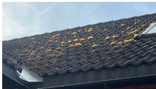
Eksempel på mosevekst.
