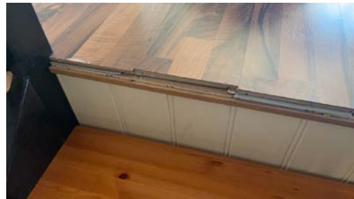
Gjenstår å montere overgangslist ved trapp.
