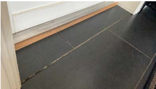
Det sprekker opp i fuger ved dører.
