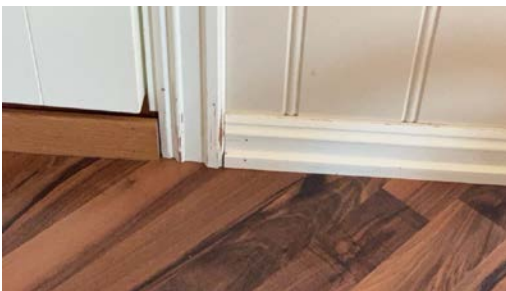
Eksempel på brukslitasje.
