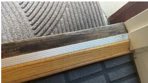
Slitasje på terskel på hovedentre
