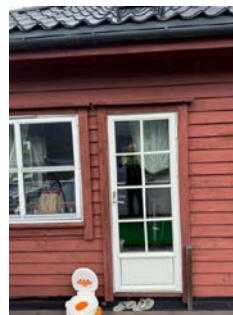
Skjevheter og manglende beslag over vannbord
