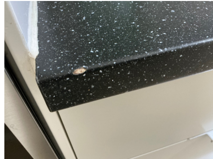
Skade på benkeplate ved steikeovn.
