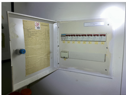
Sikringsskap står i bod.
