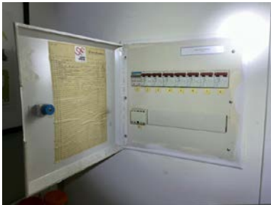
Sikringsskap står i bod.
