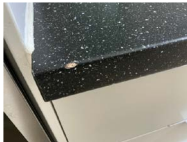
Skade på benkeplate ved stekeovn.
