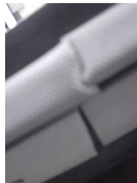
tetningslist entredør med skade
