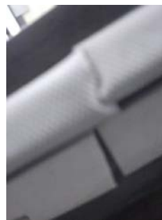
tetningslist entredør med skade
