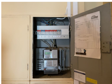
Sikringskap plassert i felles oppgang.
