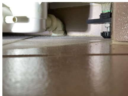
Utettheter i membran rundt rørgjennomføringer.
