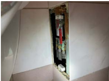
Stoppekran plassert på bad.
