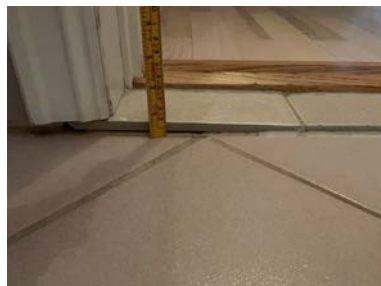
Ingen synlig oppbrett av membran ved terskel.
