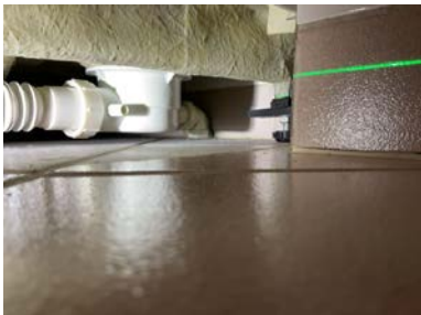
Ingen synlig mansjett rundt rør fra dusjkabinett.
