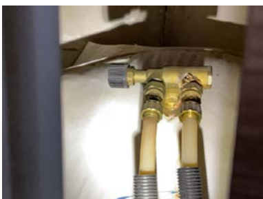
Korrodering på kobling.
