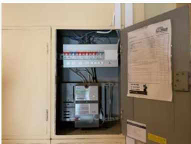
Sikringsskap plassert i felles oppgang.
