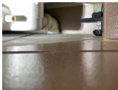
Utettheter i membran rundt rørgjennomføringer.
