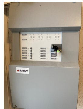
Sentral til brannvarsling, ved inngang
