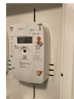
Måler (AMS) montert i skap som er felles
