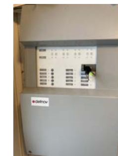
Sentral til brannvarsling, ved inngang
