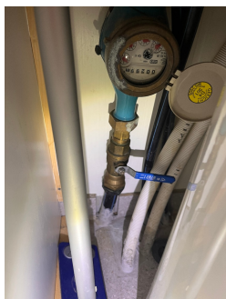
Innvendig stoppekran og vannmåler.
