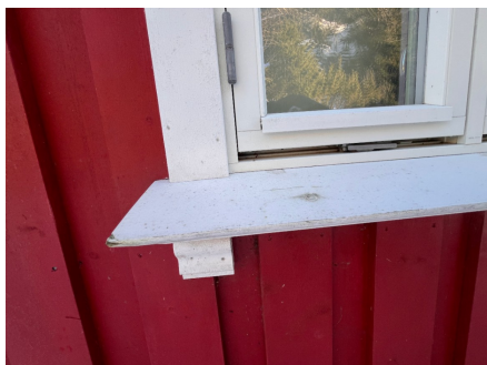
Mangler beslag, spalte mellom omramming og under vindu.
