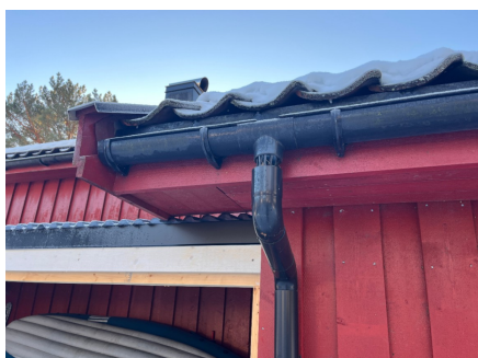
Nedløp har ikke kontakt med takrennen.
