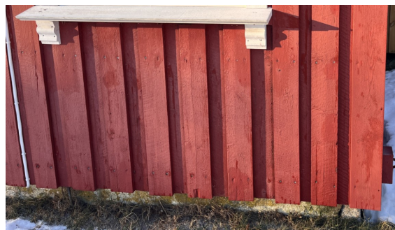
enkelte kledningsbord er sprukket.
