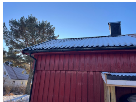
Takstige bør flyttes til andre siden av pipen.
