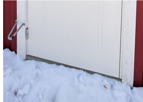
Ikke montert beslag under ytterdør.
