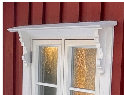
Mangler beslag og spalte mellom kledning og vannbrett.
