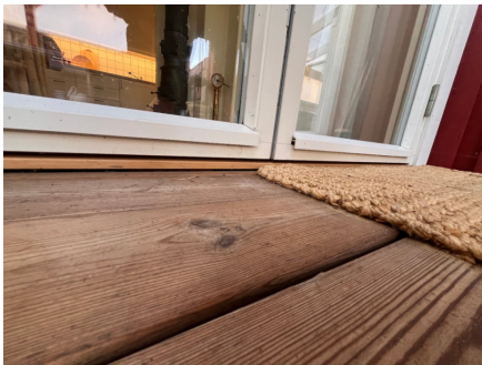
Ikke synlig beslag under balkongdør.
