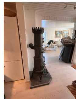
Ubrennbar plate på gulv under vedovn er litt for liten.
