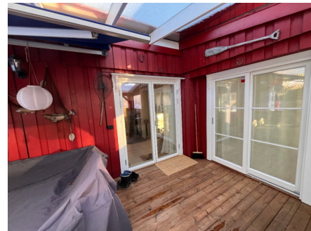
Ikke synlig beslag under balkongdør.
