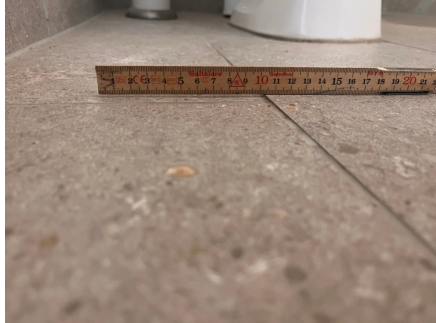
Høydeforskjell på fliser.
