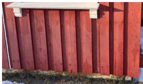
enkelte kledningsbord er sprukket.
