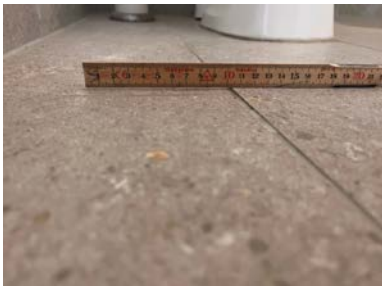
Høydeforskjell på fliser.
