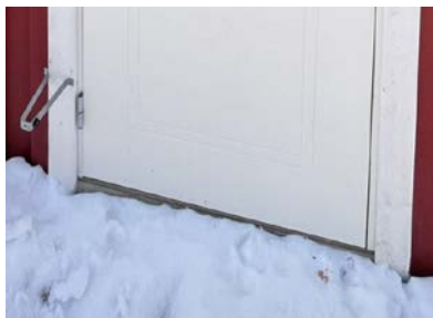
Ikke montert beslag under ytterdør.
