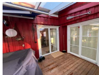
Ikke synlig beslag under balkongdør.
