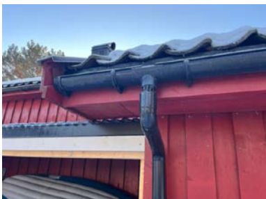
Nedløp har ikke kontakt med takrenne.
