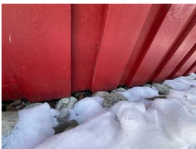
Kledning ned til terreng, kledningen er ikke kuttet med skrå for bedre vann avrenning.
