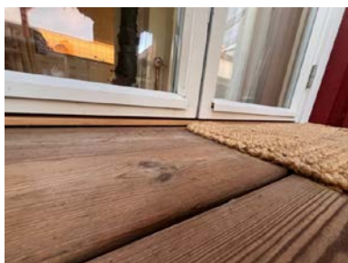
Ikke synlig beslag under balkongdør.
