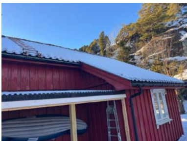
Vanskelig adkomst til takstige. Mangler snøfangere på tilbygget.
