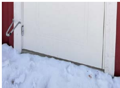
Ikke montert beslag under ytterdør.
