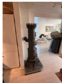
Ubrennbar plate på gulv under vedovn er litt for liten.
