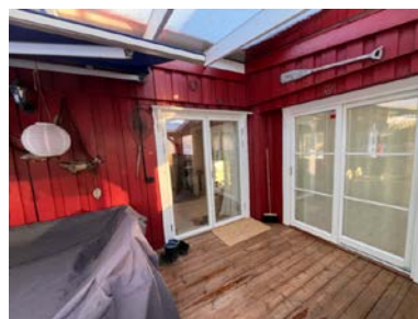
Ikke synlig beslag under balkongdør.
