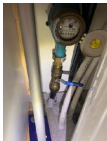
Innvendig stoppekran og vannmåler.
