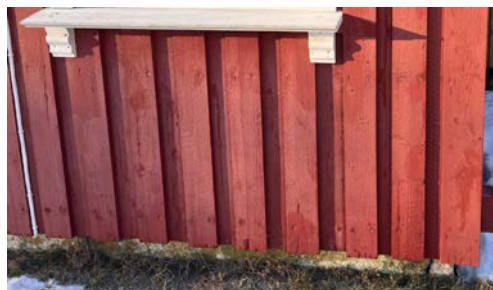
enkelte kledningsbord er sprukket.
