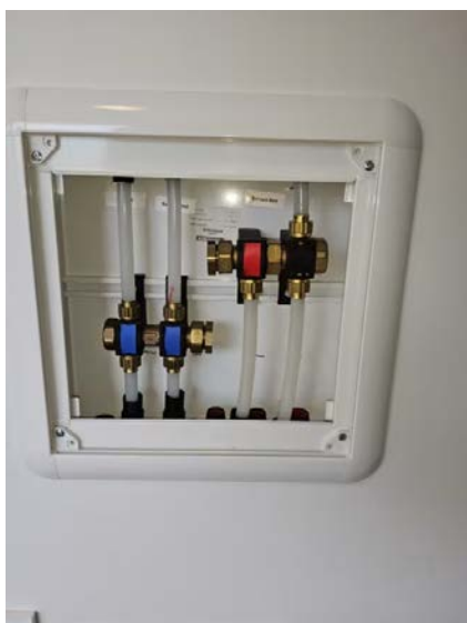
Bilde viser fordelerskap for rør i rørsystem.
