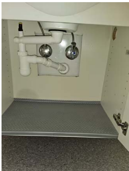
Bilde viser avløpsrør på bad.
