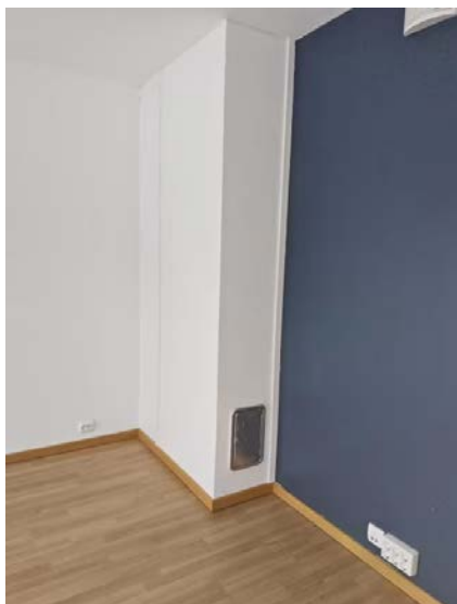
Bilde viser pipeløp.
