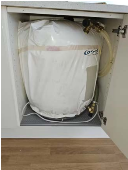
Bilde viser varmtvnsbereder.
