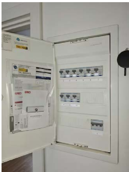
Bilde viser sikringsskap.
