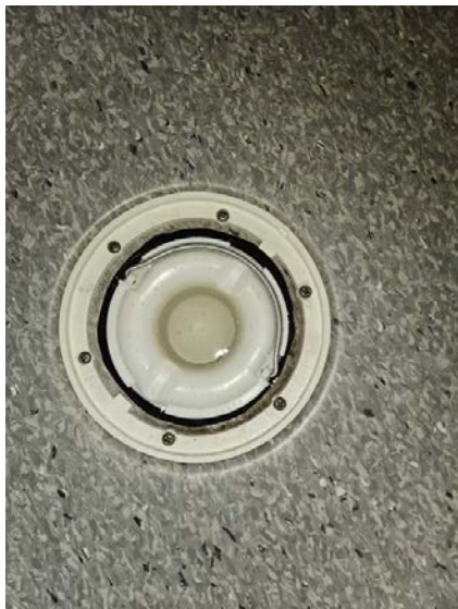
Bilde viser sluk på bad.
