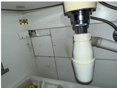
Ufagmessig tetting av tidligere hull.
