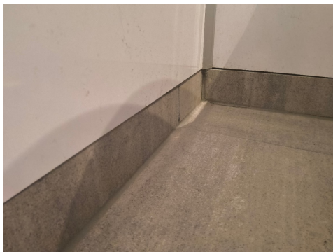
Feil montering av baderomsplater.
