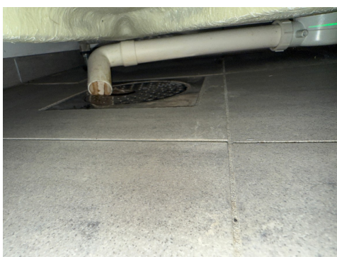
Begrenset tilgang til sluk.
