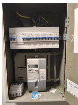
Sikringsskap med jerdfeilautomater.
