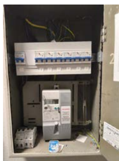
Sikringsskap med jordfeilautomater.
