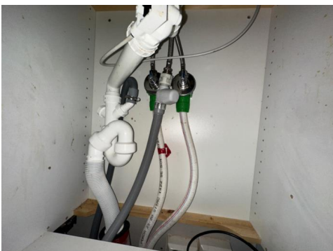
Røropplegg i kjøkkenbenk
