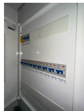
Sikringssskap med automatsikringer.
