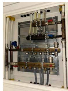
Samleskap for vannrør på bad
