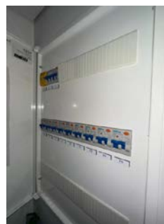
Sikringsskap med automatsikringer.
