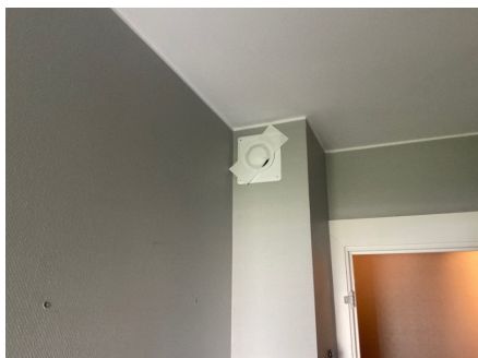
Avtreksventilen på kjøkkenet.
