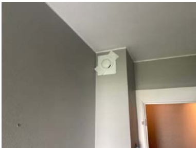
Avtreksventilen på kjøkkenet.
