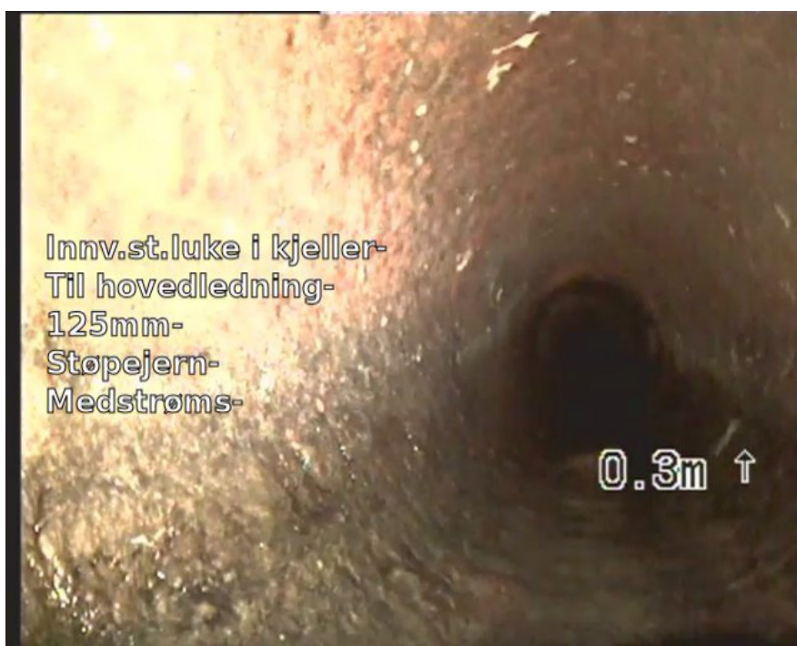
UB 0,30m Rust, fett og sedimenter, Gradering 1, Type: Utfelling, Kl 4-8
