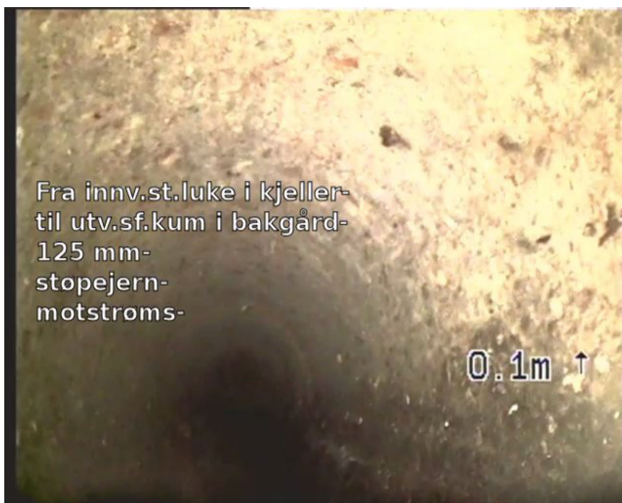
KS 0,00m Korrosjon/slitasje, Gradering 2, Kl 12-12
