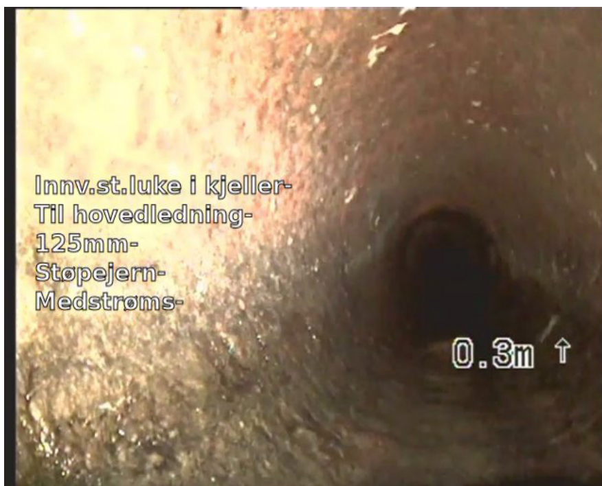
KS 0,00m Korrosjon/slitasje, Gradering 2, Kl 12-12
