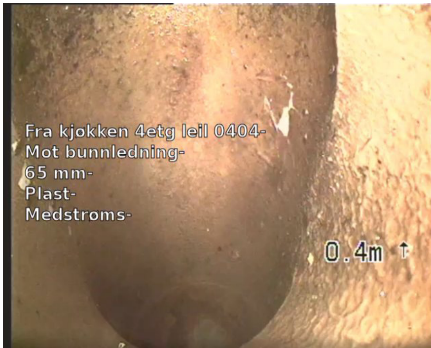
UB 0,00m Rust, fett og sedimenter, Gradering 1, Type: Utfelling, KI 12-12
