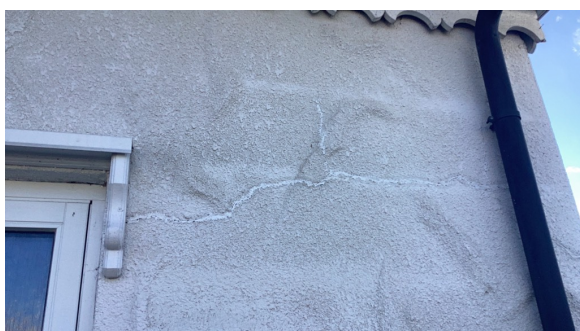
Eksempel på sprekker i mur.
