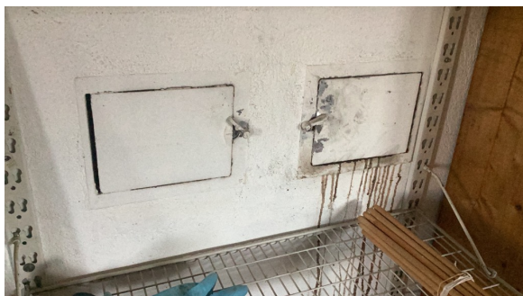
Sotluker i garasje.
