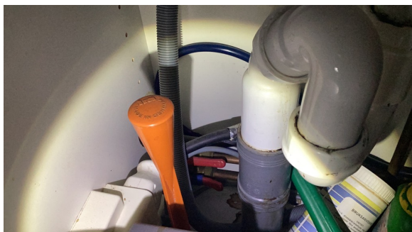
Vanninntak med stoppekraner i kjøkkenbenk.
