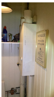
Sikringsskap plassert på toalettrom.
