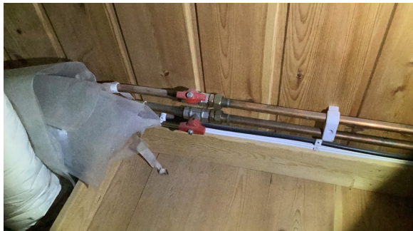
Vanninntak med stoppekraner.
