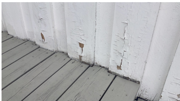
Eksempel på slitasje.
