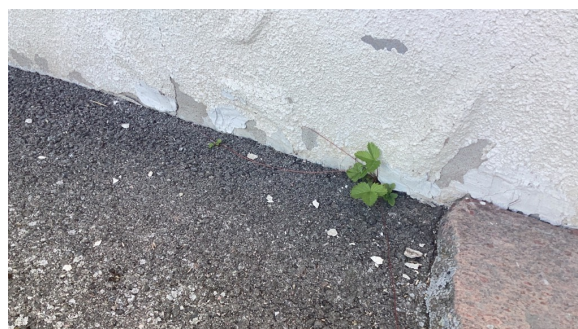
Eksempel på avskaling av maling.
