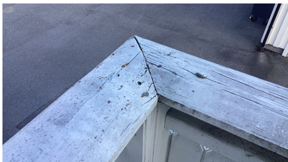
Eksempel på slitasje.
