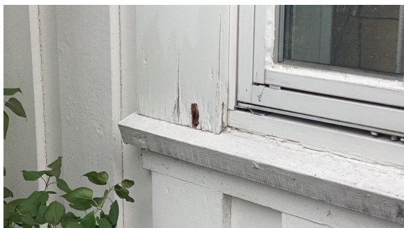
Råte på omramming rundt vindu.
