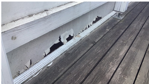
Eksempel på slitasje.
