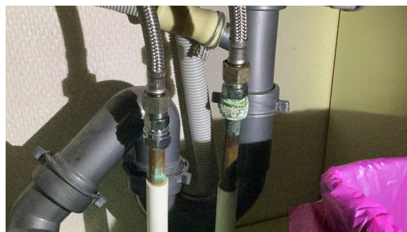
Stedvis korrosjon på skjøter.
