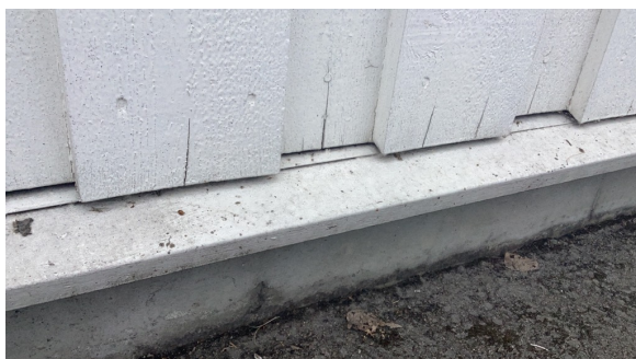
Eksempel på oppsprekking i kledningsbord.
