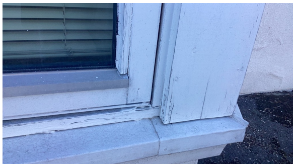
Eksempel på slitasje.
