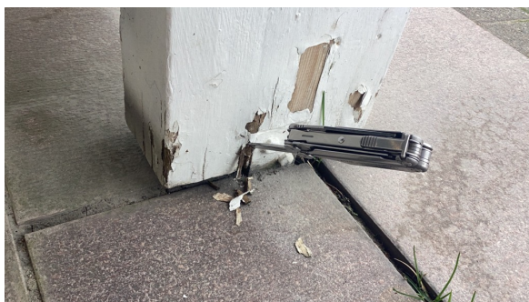
Søyle med begynnende råteskade.
