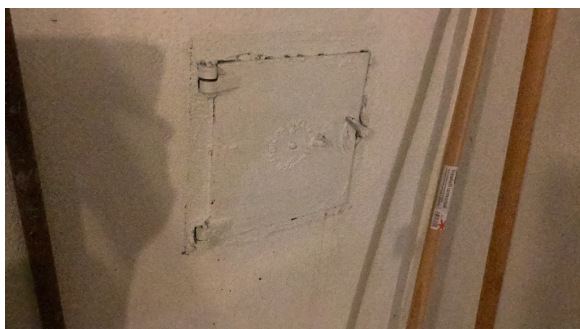
Sotluke i kjeller.
