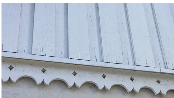
Eksempel på sprekker i trekledning.
