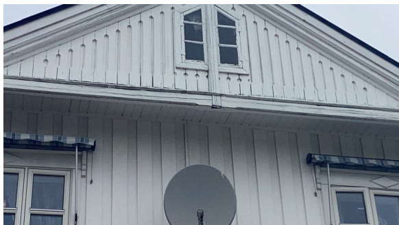
Kors i gavler har oppsprekking.
