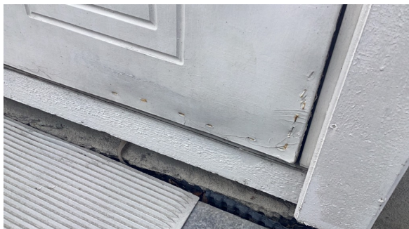
Svelleskade på dør til kjeller.
