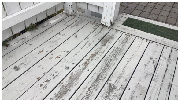
Eksempel på slitasje på gulvbord.
