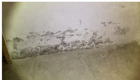
Eksempel på fuktpåkjenning og avskaling.
