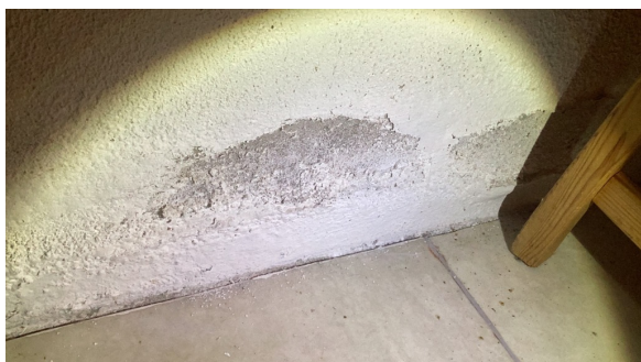
Eksempel på fuktpåkjenning og avskaling.
