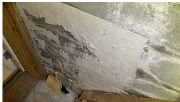
Saltutslag og avskaling i kjellertrapp.
