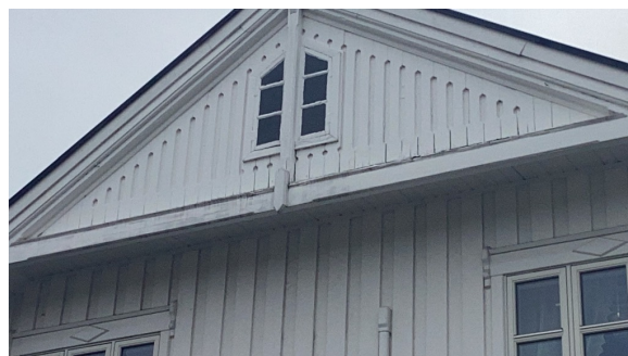
Oppsprekking mellom kledningsbord på gavlvegg.
