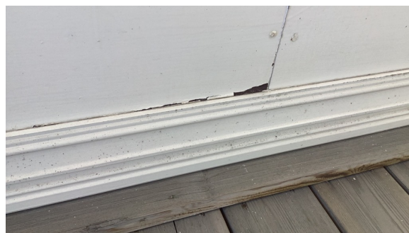
Eksempel på slitasje på balkong.
