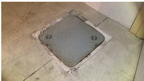
Det er kum i gulv i kjeller, ukjent hva dette er.
