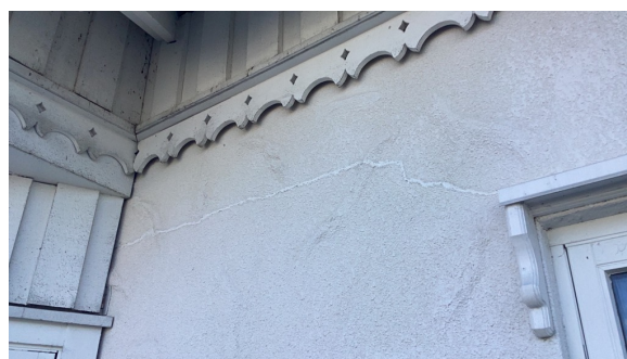
Eksempel på sprekker i mur.
