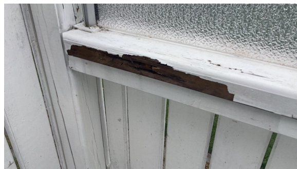
Råte på toppbord på rekkverk
