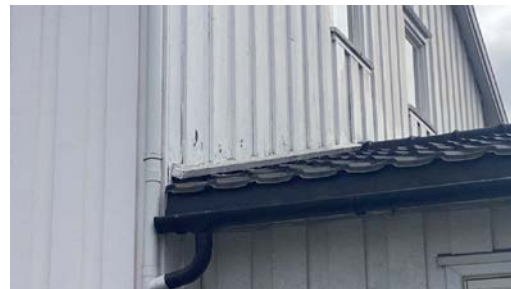
Eksempel på slitasje.
