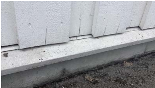
Eksempel på oppsprekking i kledningsbord.
