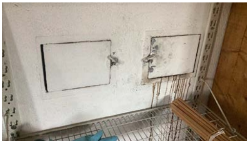
Sotluker i garasje.
