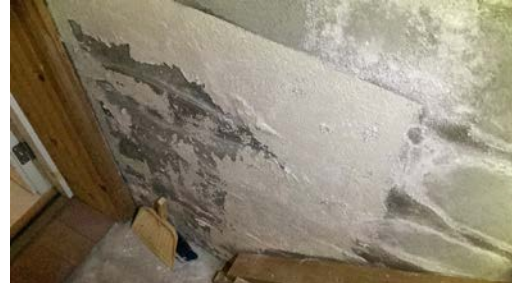
Saltutslag og avskaling i kjellertrapp.
