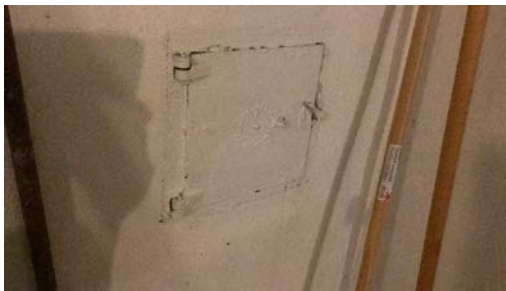
Sotluke i kjeller.
