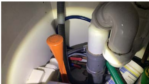
Vanninntak med stoppekraner i kjøkkenbenk.
