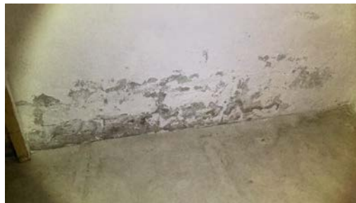
Eksempel på fuktpåkjenning og avskaling.
