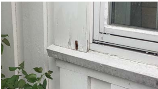
Råte på omramming rundt vindu.
