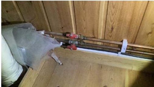
Vanninntak med stoppekraner.
