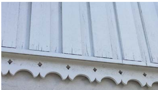
Eksempel på sprekker i trekledning.
