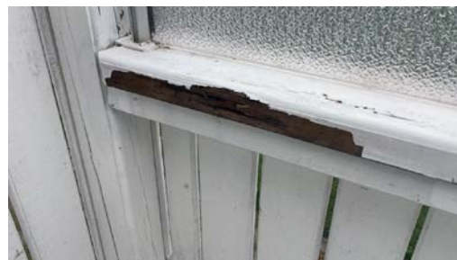
Råte på toppbord på rekkverk
