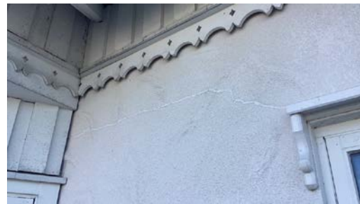
Eksempel på sprekker i mur.
