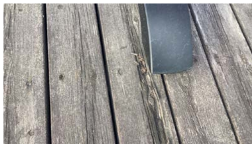
Eksempel på råte i gulvbord.
