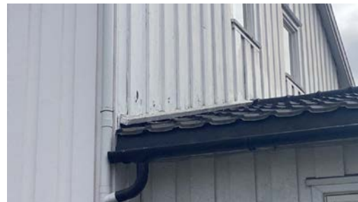
Eksempel på slitasje.
