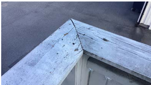
Eksempel på slitasje.
