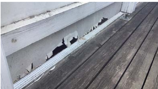
Eksempel på slitasje.
