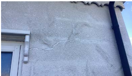
Eksempel på sprekker i mur.
