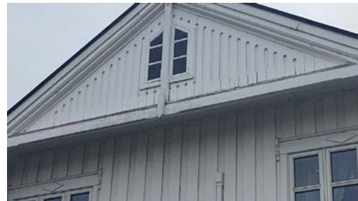
Oppsprekking mellom kledningsbord på gavlvegg.
