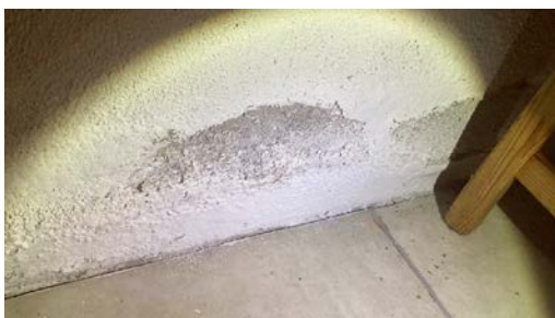
Eksempel på fuktpåkjenning og avskaling.
