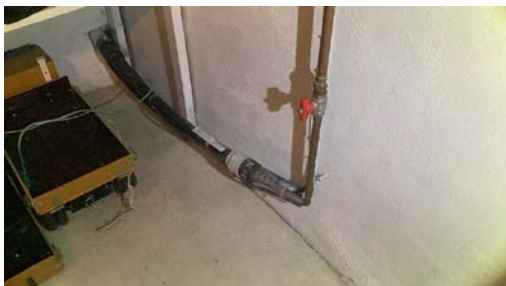
Antas å være vanntilførsel som sendes videre til hybelhus.
