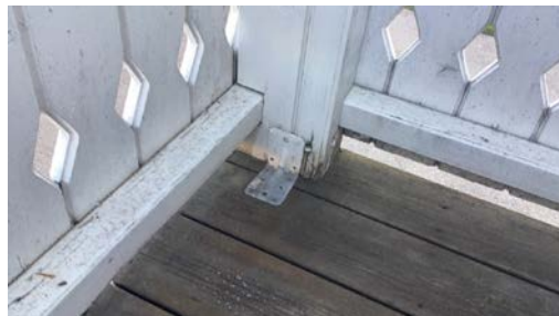
Eksempel på slitasje.
