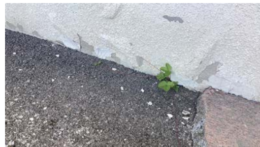
Eksempel på avskaling av maling.
