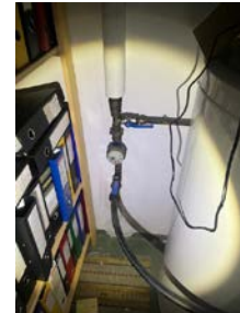
Hovedinntak til eiendommen med hovedstoppekran og felles vannmåler i kjeller.
