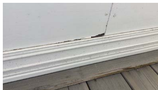
Eksempel på slitasje på balkong.
