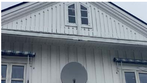
Kors i gavler har oppsprekking.
