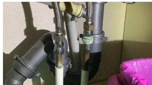
Stedvis korrosjon på skjøter.
