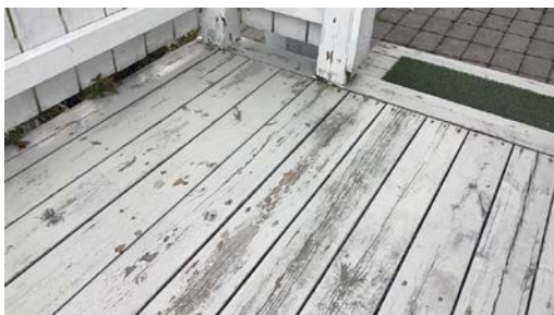
Eksempel på slitasje på gulvbord.
