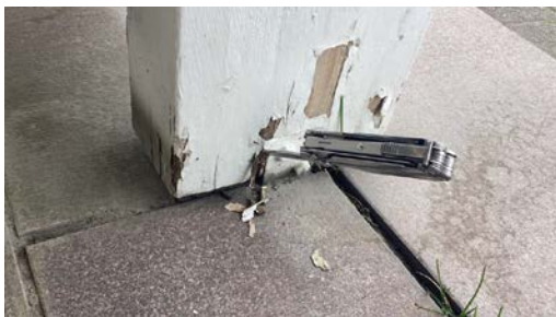
Søyle med begynnende råteskade.
