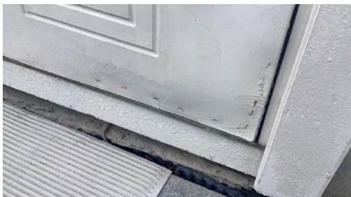
Svelleskade på dør til kjeller.
