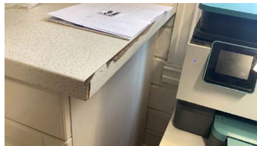
Eksempel på slitasje.
