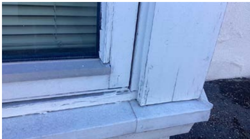
Eksempel på slitasje.
