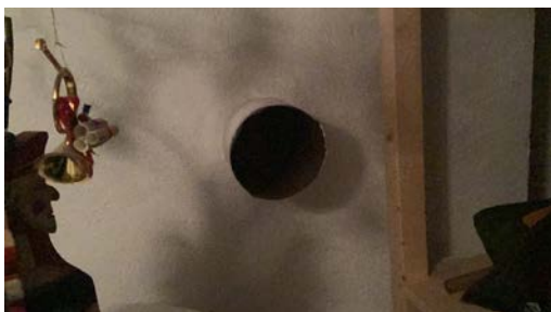
Åpent røykrør i kjeller.
