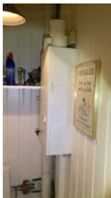
Sikringsskap plassert på toalettrom.
