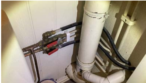
Vanninntak med stoppekraner til næringsdel i 1. etasje.
