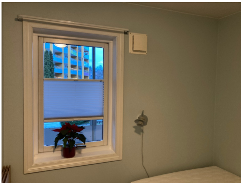
Ventil i vegg på soverom
