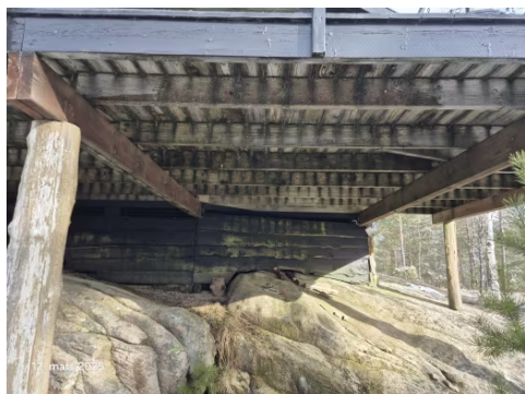
Bilde tatt fra under terrassen. Grønske og normal slitasje.
