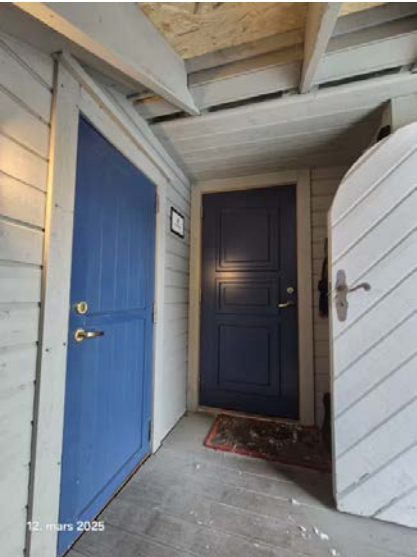
Dør til venstre i bildet går til teknisk rom. Denne må justeres.
