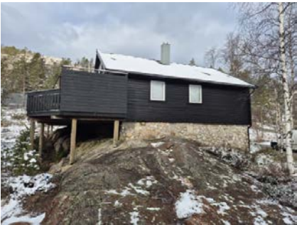
Ikke stigetrinn på tak eller snøfangere på tak.
