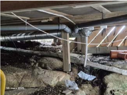
Bildet er tatt fra under hytta. Viser åpent rørsystem, og rør som ikke er isolert.
